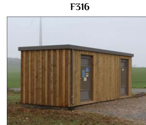
Poste de livraison habillé d'un bardage bois Source : société ERG Développement France
